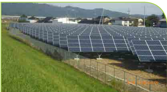
Shima Project : Toyama, Japan 1.25 MW COD : 1 March, 2016
