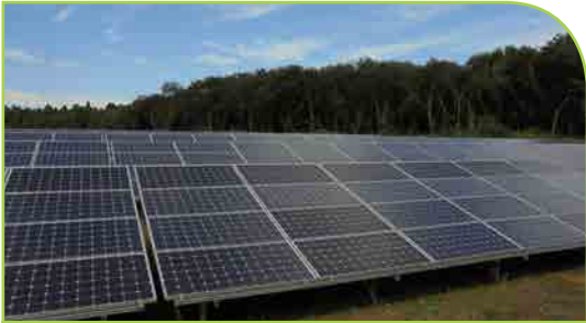
Kuno Project : Ibaraki, Japan 0.5 MW COD : 18 August, 2015
