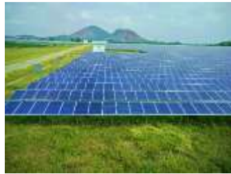
SSE1-PV08 (8MW) COD JUN 2014
